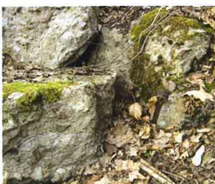
Fot. 34. Ruiny schronu (3c) w rejonie naroża ściany czołowej i lewej. Z lewej strony wystający z betonu koniec szyny kolejki wąskotorowej.
