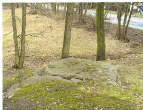
Fot. 30. Schron (3a), widok na strop od południa. Widoczne niesymetryczne rozszerzenie i pęknięcia, wejście zasypyane.
