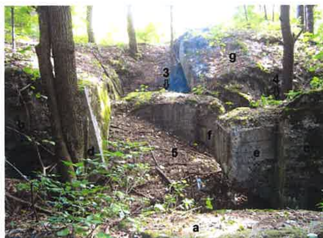
Fot. 23. Schron (2f), widok z płn. zachodu. Widoczny odrzucony do przodu fragment lewej ściany (a), miejsca oderwania tej ściany i orylonu (b, c), wnęka po płycie pancernej (d, e), zasypane częściowo wnętrze kazamaty (5), ściany oddzielające ją od pomieszczenia załogi (3) i obserwatora (4), do którego prowadzi przejście (f). Po lewej odchylona wybuchem ściana czołowa, po prawej w głębi część stropu (g).
