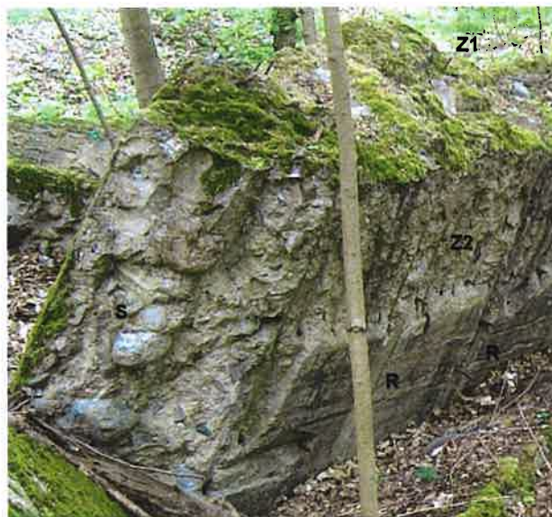
Fot. 13. Strop schronu (2a), widok z zachodu. Widoczne pręty zbrojenia z siatki górnej (Z1) i dolnej (Z2), dwa rowki (R) po listwach mocujących boazerie oraz odcisk szyny i górna warstwa betonu z otoczkami (S).
